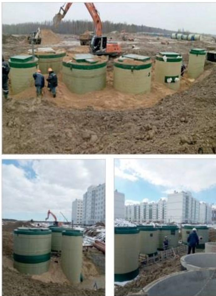
Рис. 2. Монтаж комплектных КНС (разработка, производство и поставка изделий в составе комплектов, шеф-монтаж и наладка – АО «Промэнерго») при строительстве систем инженерного обеспечения объектов жилищной застройки квартала в районе Янино-1 (Ленинградская обл., Всеволожский район)
