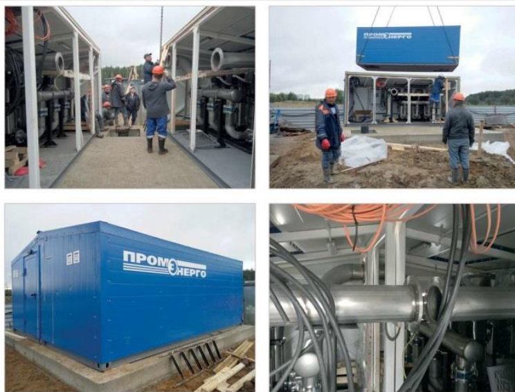
Рис. 5. 2-х секционная повысительная водопроводная насосная станция (разработка, производство, поставка, шеф-монтаж и наладка – АО «Промэнерго»), реализованная в соответствии с проектом при строительстве систем инженерного обеспечения объектов жилищной застройки квартала в районе Янино-1 (Ленинградская обл., Всеволожский район)
