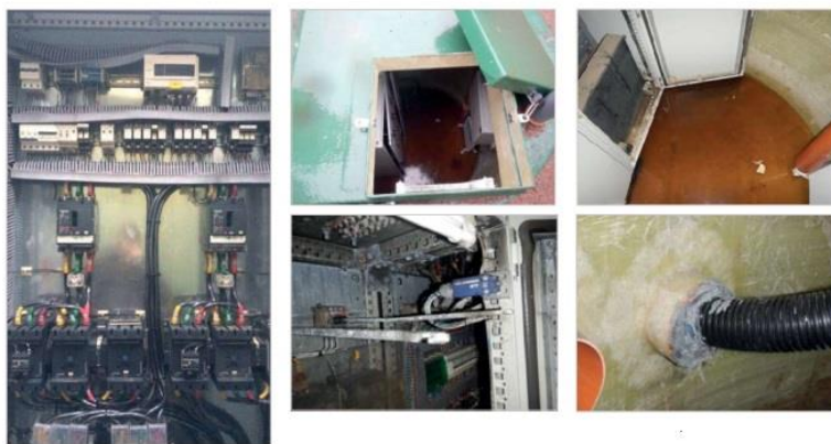
Рис. 4. Пример «затопленного» в резервуаре шкафа управления
